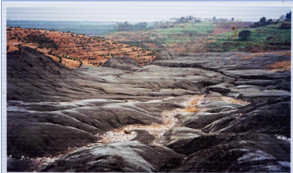
Erosão de escombreiras de pirite localizadas no antigo parque de minério junto à antiga estação ferroviária, a montante dos pantanais de ribeira - Lousal, 2002 Erosion of pyrite ore tailings, located upstream of the wetlands, near the old railway station, Lousal, 2002
