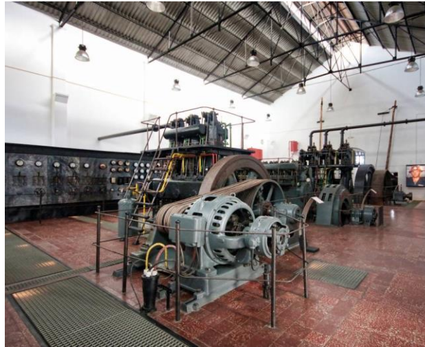
Geradores de eletricidade
